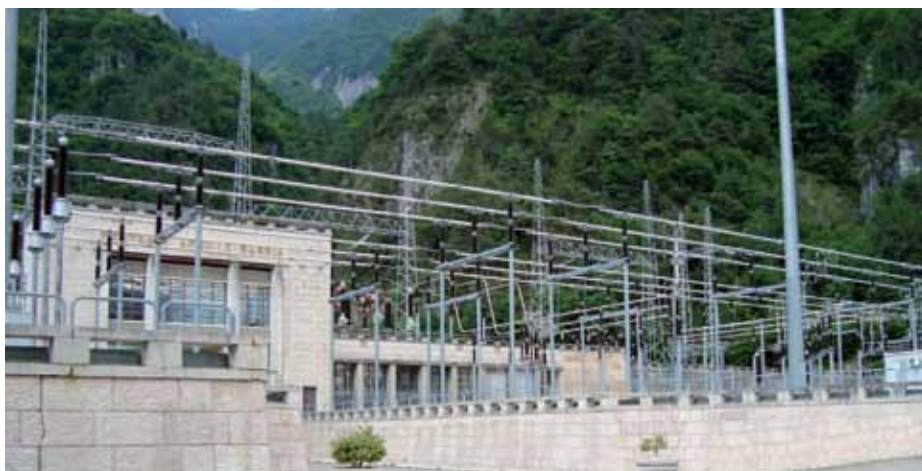
La centrale Enel di Soverzene, uno dei maggiori impianti idroelettrici del Veneto
